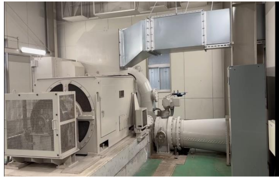
遠隔からの自動巡視点検
